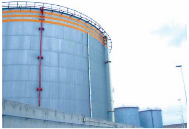
Figura 2 - Muchos hidrocarburos se almacenan a temperatura y presión atmosféricas. Por tanto, si la sustancia emite vapores y en el interior hay aire, hay que aplicar el RD 681/2003.
