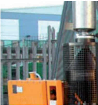
Figura 41 - Caja ignífuga de sistema de combustible.
