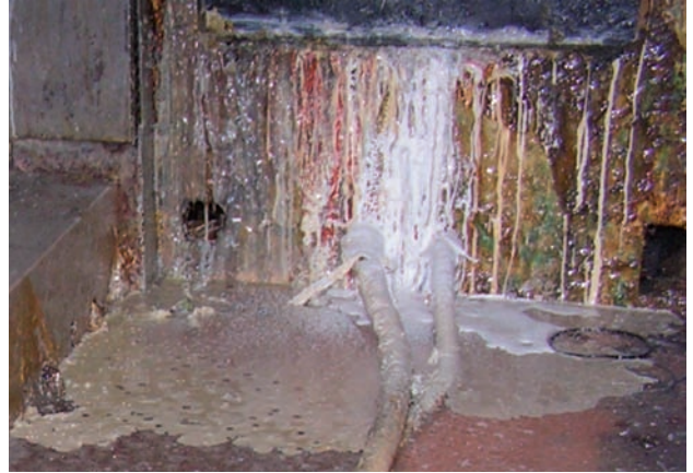
Figura 16 - Los derrames y acumulación de sustancia inflamables deben ser eliminados inmediatamente con procedimientos adecuados para evitar su filtración.
