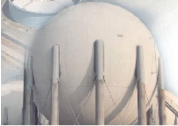
Figura 1 - Por ejemplo: el gas natural licuado se almacena a presión atmosférica y temperatura -161^{\circ}\text{C} . En su interior no hay aire, luego no es de aplicación el RD 681/2003.
